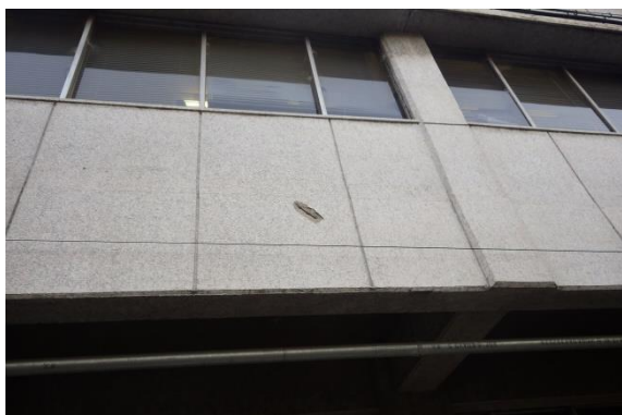
図 1-2 本庁舎老朽化の状態①
