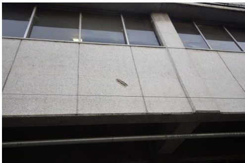
本庁舎老朽化の状態①
