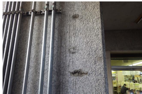
本庁舎老朽化の状態②
